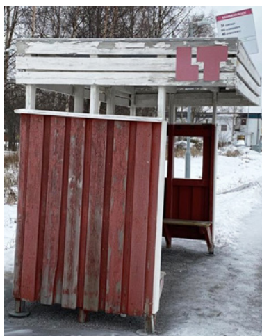
Busskur som behöver bytas ut.
